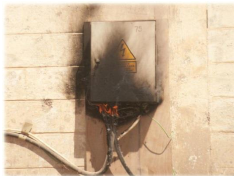
(ข)เพลิงไหม้เกิดจากไฟฟ้าลัดวงจร
